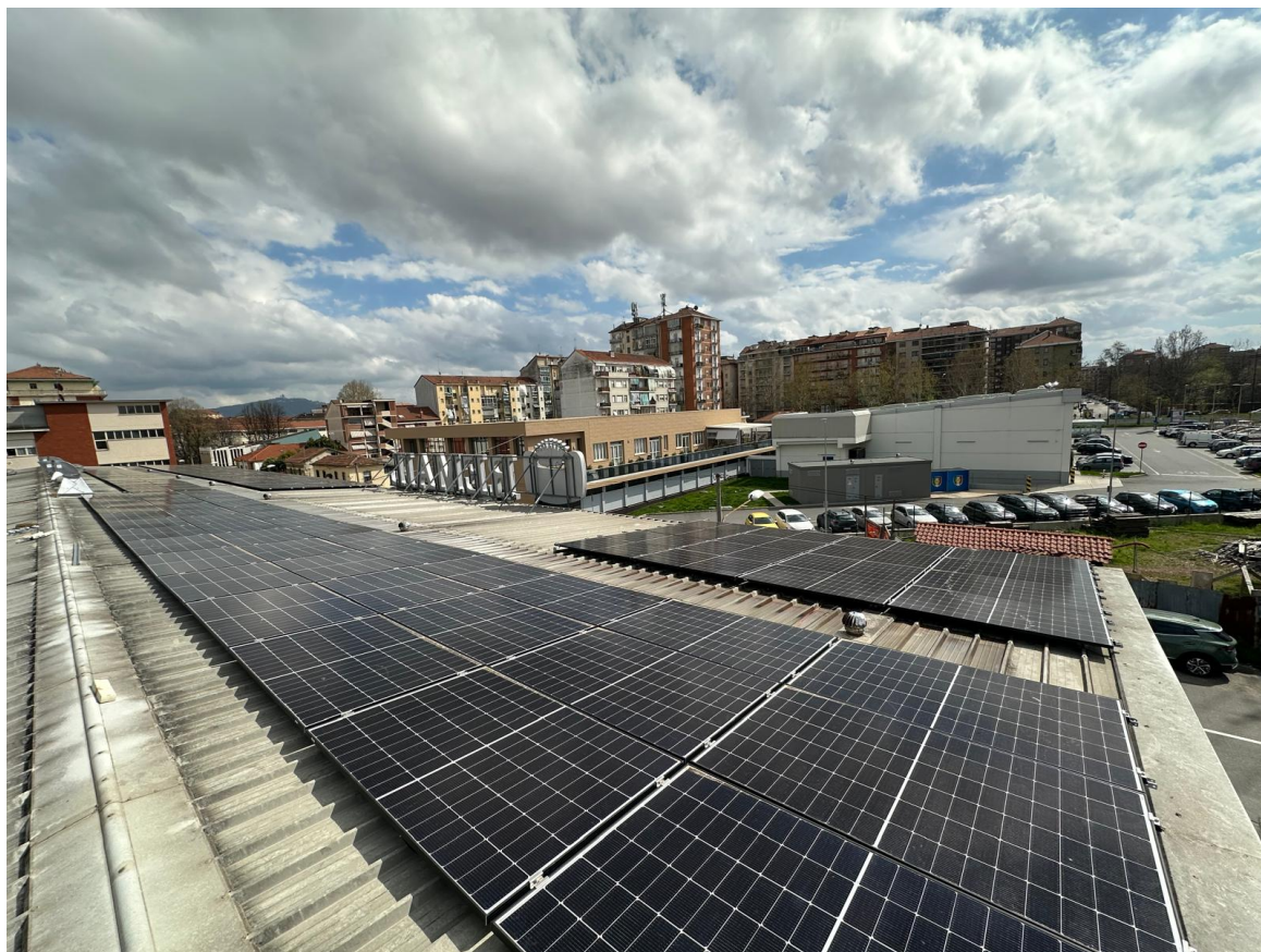
Nuovo impianto fotovoltaico di Via Orbetello, Torino
